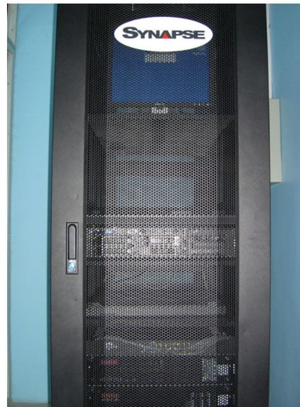
数字化存储机房
